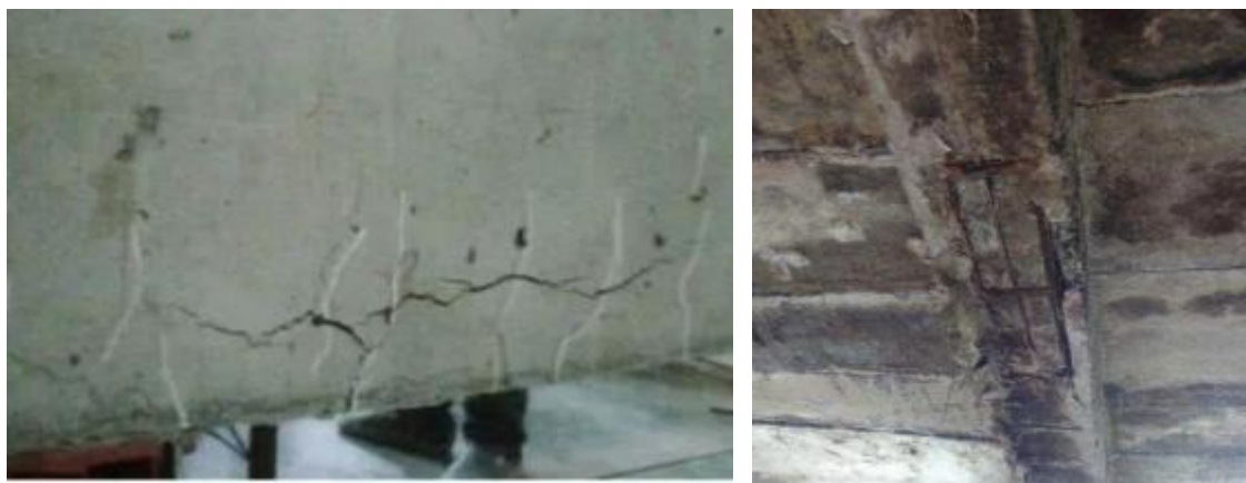
图2.6.1 梁混凝土裂缝及露筋的问题
