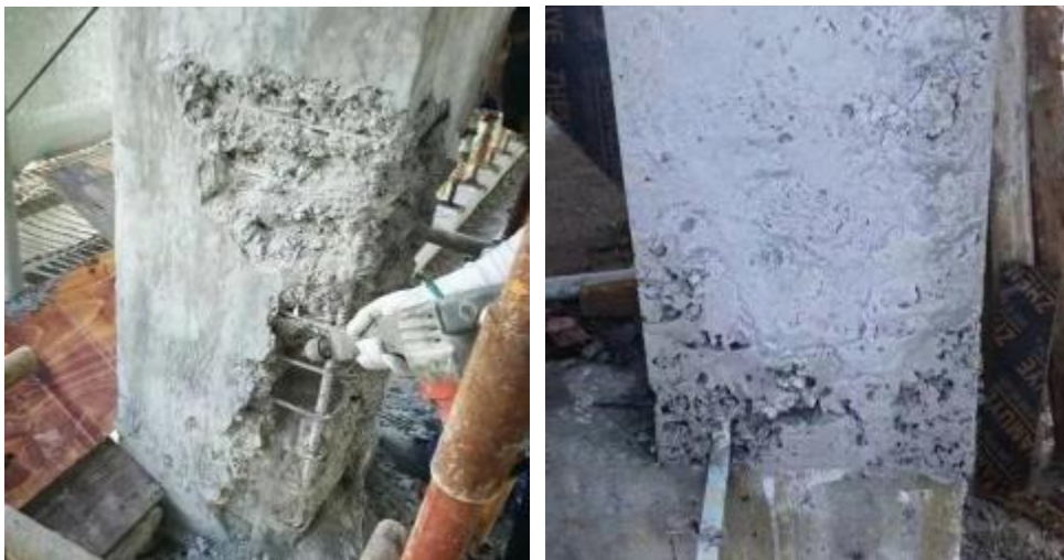
图2.1.1 柱混凝土强度较差及蜂窝麻面的问题
