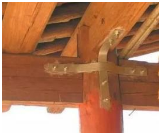
图3.1.1 梁枋榫头连接处加固一
