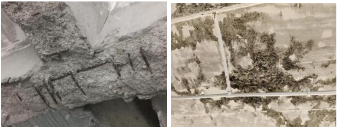
图2.4.1 梁混凝土强度较差及蜂窝麻面的问题
